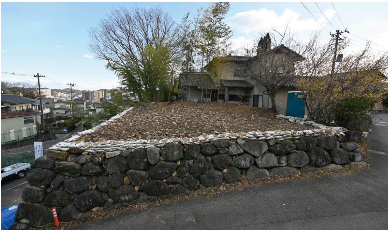
東日本大震災で上部が崩落した磐城平城塗師櫓の全景（石垣内部全面に栗石が敷き詰められている）
